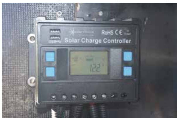
Die Ladestation wird ausgiebig genutzt
